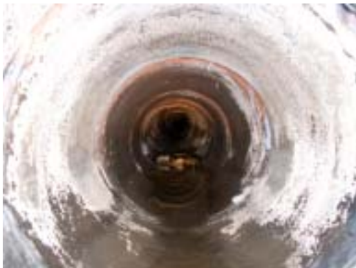
1 m ~ 3 m 先まで水が溜まって逆勾配になっている
